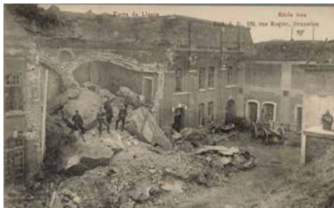
Het vernielde officiersgebouw na WO I door een 42cm projectiel, de schade is indrukwekkend en werd vaak gefotografeerd door de Duitse bezoekers. De schade is vandaag nog altijd zichtbaar
