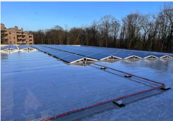
Zonnepanelen op het dak van sporthal 't Spui
